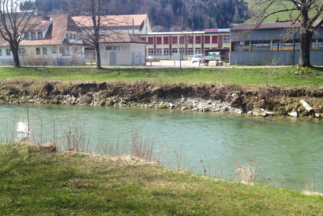
Stark beschädigter Uferabschnitt der Thur
